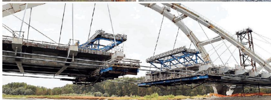
Strade da sistemare e opere da finire: la ex statale dei Giovi tra San Martino e Pavia, via Xx Settembre a Voghera e il ponte sul Ticino a Vigevano
